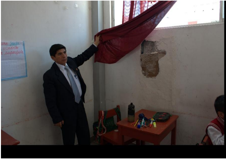
COLEGIO PROVISIONAL, SEÑALES DE LA PRECARIEDAD DE LAS INSTALACIONES
